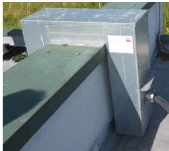
Bild 4: Verlegung von Leitungen über eine Brandwand mittels Brandschutzkanal (Quelle VGH)
