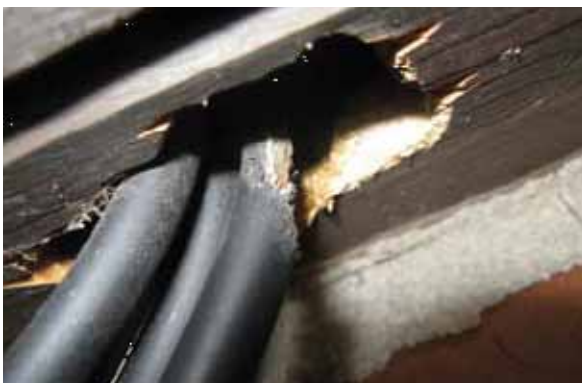
Bild 12 und 13: Beschädigungen von Leitungen (Quelle Markus Scholand)
