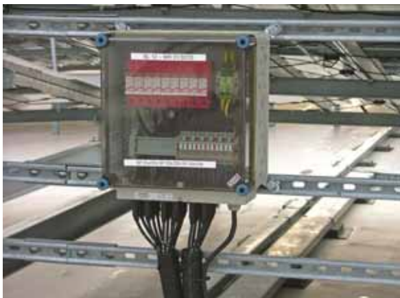
Bild 20: Generatoranschlusskasten mit Überspannungsschutzgeräten (Quelle Hensel)
