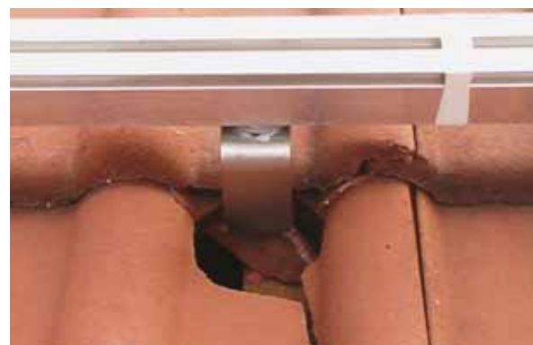
Bild 7: fehlerhafte Planung (Quelle Mannheimer)
