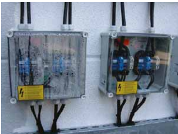
Bild 17: Kondenswasserbildung im Generatoranschlusskasten (Quelle Markus Scholand)
